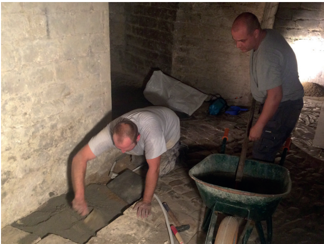
Opération de repose du dallage dans un lit de sable stabilisé par les opérateurs de la SRAB, Frédéric Légat et Laurent Benois.
