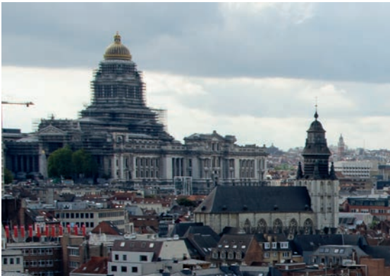
Fig. 6. Vue d'ensemble du palais de Justice sous les échafaudages qui en cachent l'architecture et les décors, photo SRAB.
